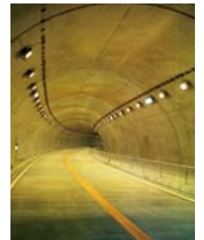
トンネル照明
